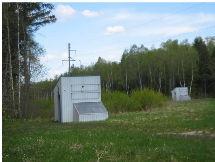
Joonis 4.1 Uusküla I ja II puurkaevpumplate välisvaade
