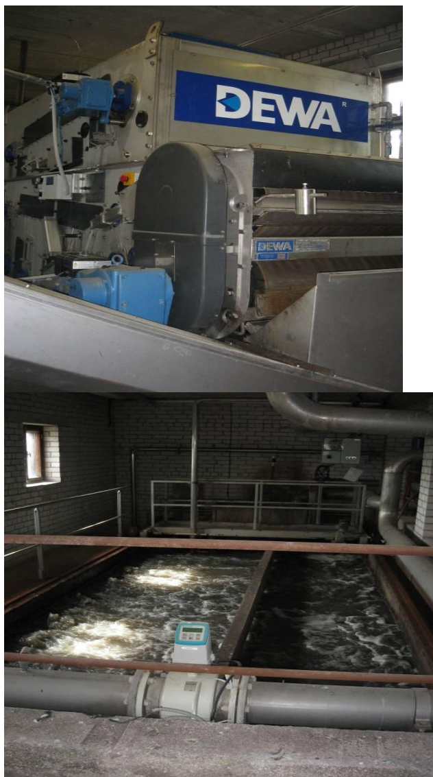
Joonis 5.5 Rapla reoveepuhasti mudapress ja liivapüünis
