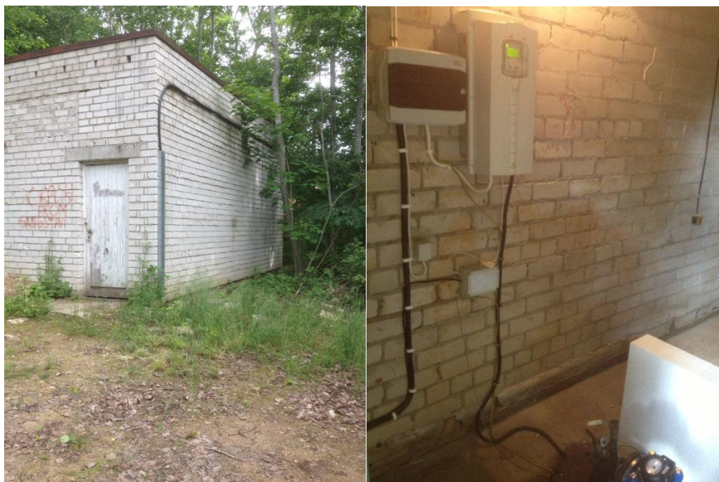
Joonis 4.3 Uusküla puurkaevpumpla välisvaade ja puurkaevu päis soojustusega
