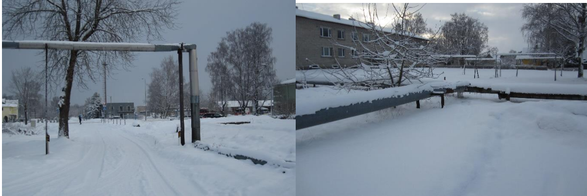
Joonis 3.2. SW Energia maapealsed kaugküttetorustikud
